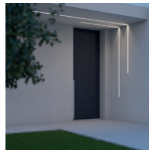
Installazione outdoor con giunto luminoso verticale e strip LED IP65.
